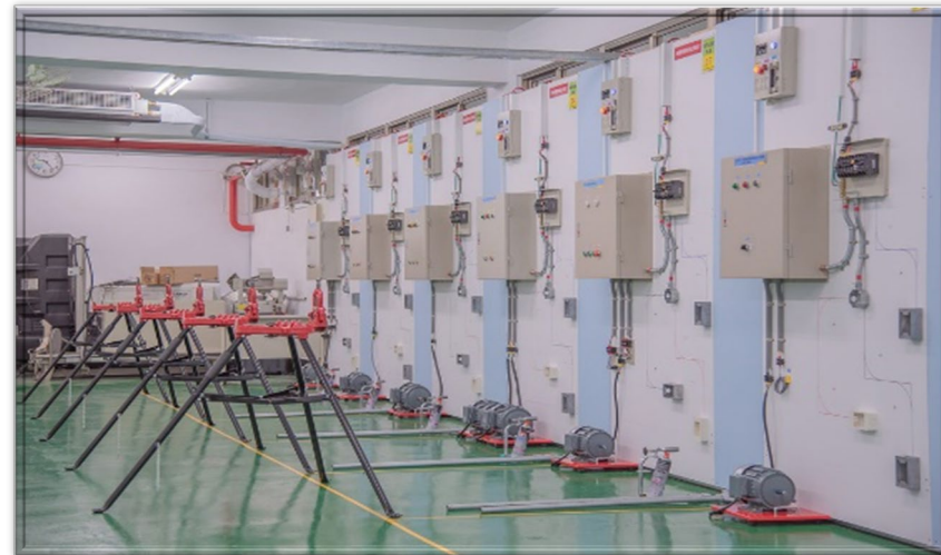
配管配線實習工廠(E棟)
