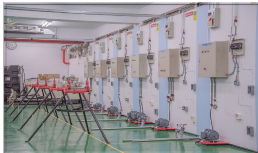
配管配線實習工廠(E棟)
